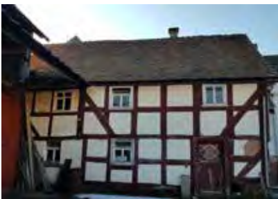
Marode Bausubstanz im Altort
