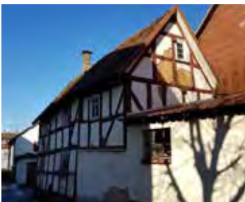
Leerstand im schlechten Zustand
